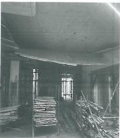
临时通道口上方模板未拆除到位，模板悬空
