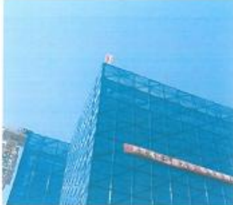
爬架外侧防护网片存在较大缝隙的已整改
