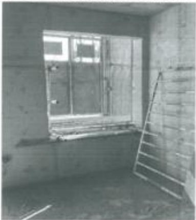
施工升降机接料平台，定型防护缺失。
