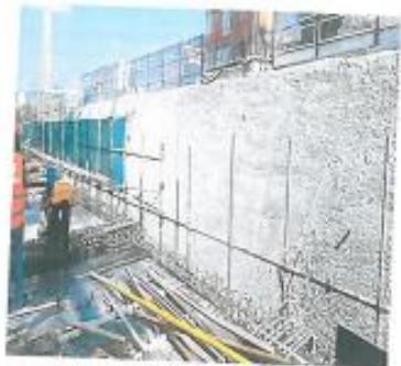
东地块施工现场捆绑在脚手架上的电箱已拆除
