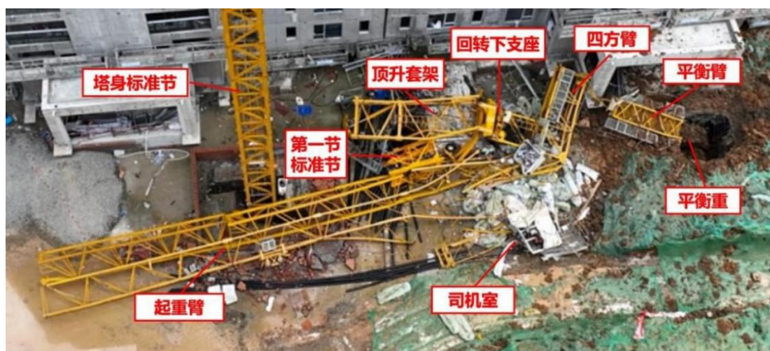
图 5 事故塔机现场俯视图
