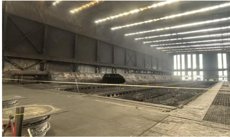
图 7 事故发生后 M9-L606 石墨化炉炉头的状况
