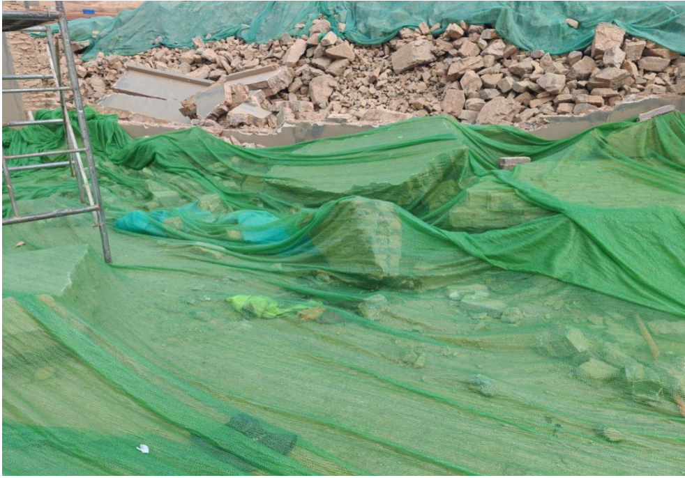
图二：事故现场照片
