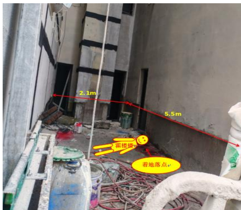
图 5 霍某楼着地后的位置
