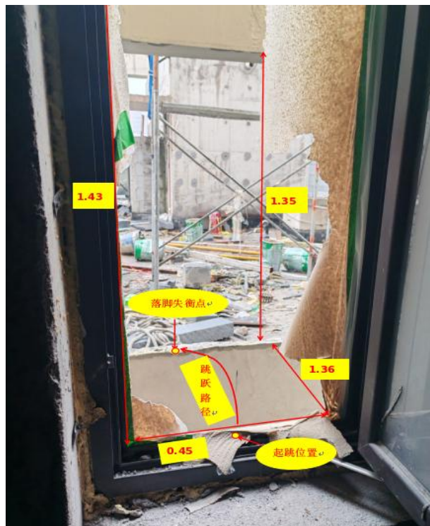
图 2 17#楼二单元 21 层卫生间窗口事故发生点位置现场图
