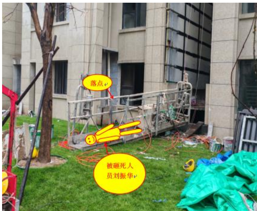
图 4 霍某楼在 7 层吊篮上的落点以及刘某华的位置
