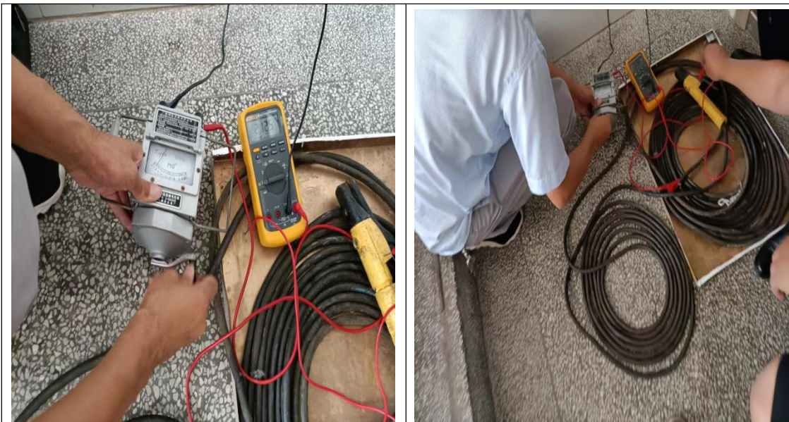
图 10、图 11 电焊机电缆线绝缘偏低，漏电压合格
