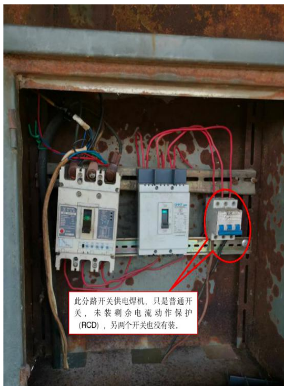
图 17：接焊机开关无漏保
