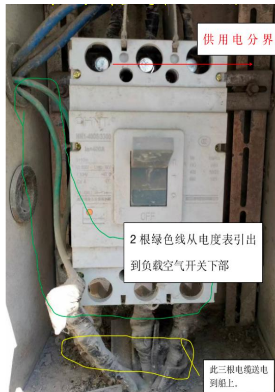
图 18：户外空气开关无漏保
