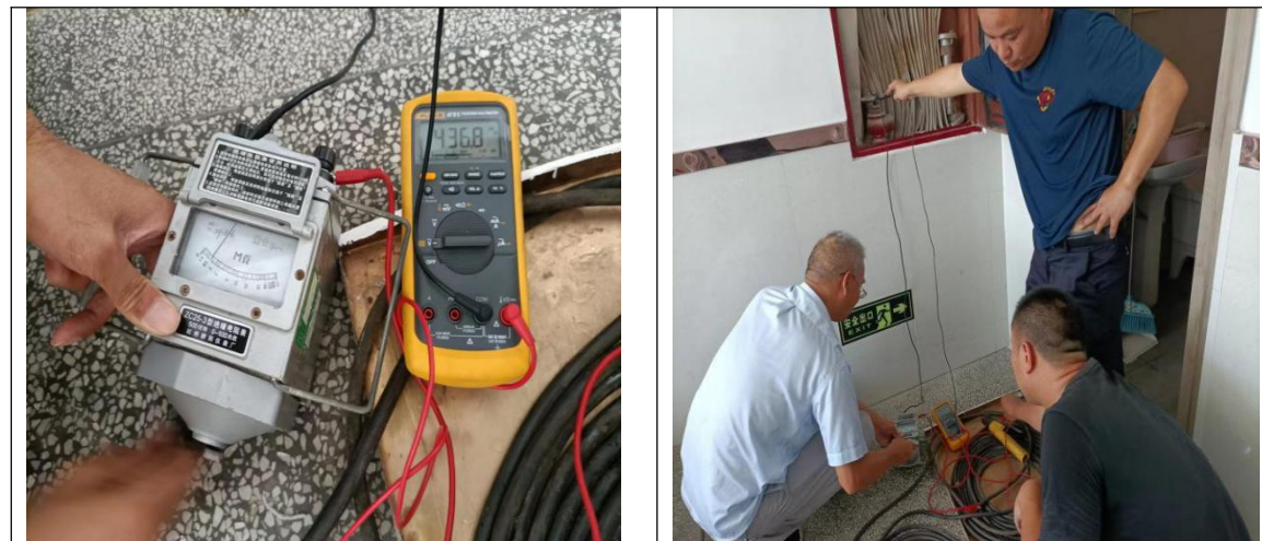
图 12、图 13 电焊机焊钳外绝缘、漏电压检测合格
