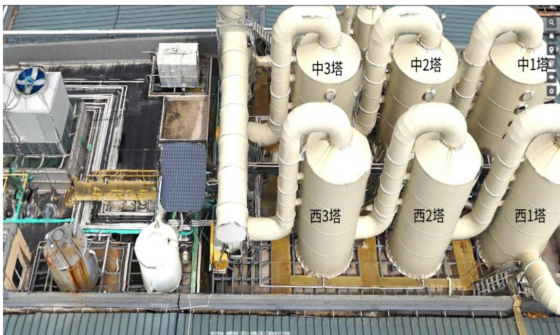
图2 废气处理装置航拍图(由西往东 )
