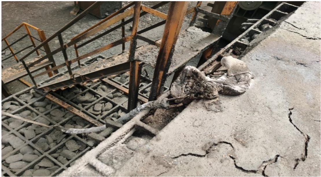
图二 液压管烧毁情况
