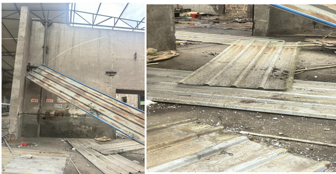
图 3 事故发生点现场散落的夹芯板照片
