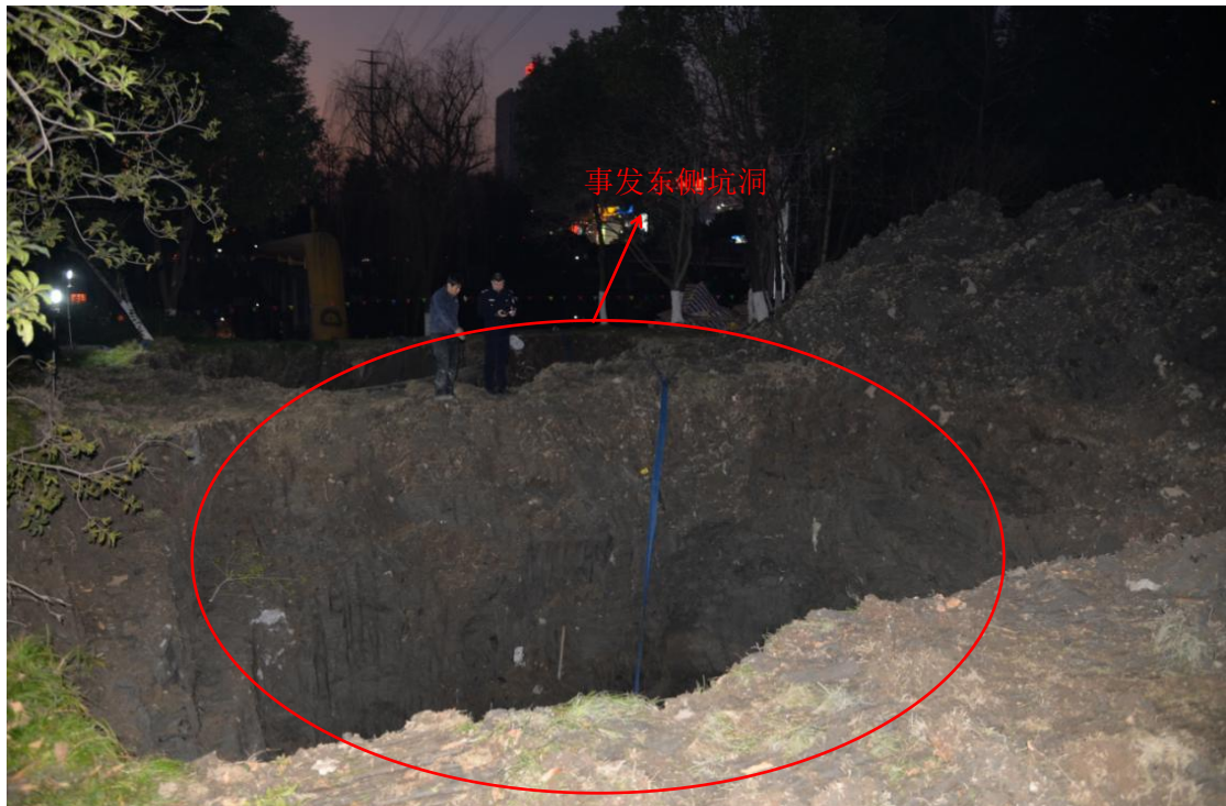
图2 事发坑洞概貌照片
