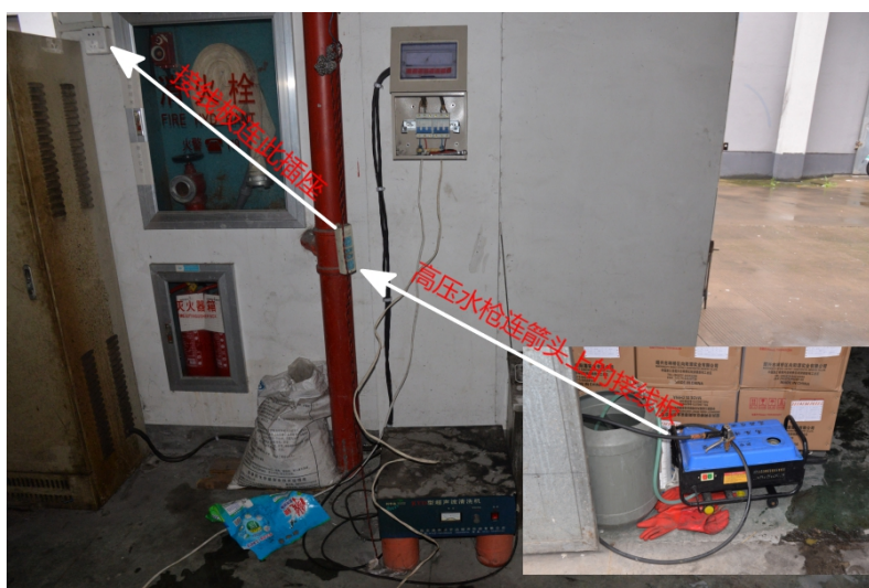
图 3 高压清洗机绝缘电阻检测现场图
