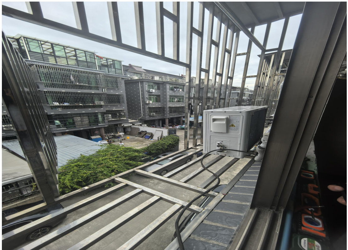
图 2 事故现场典型照片
