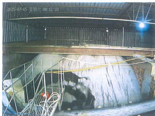
料仓 1 号库石粉料发生坍塌
