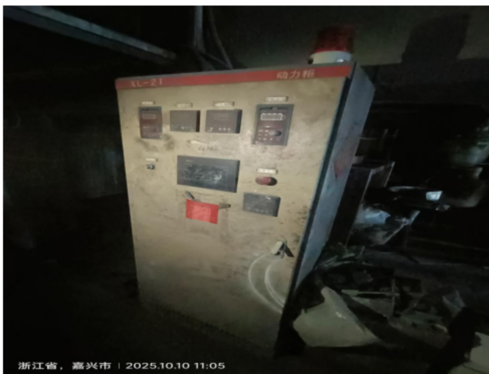
图 12：喷房的东北侧为 1 号喷塑线的 XL-21 动力柜，柜体及附近未见用电安全警示标识
