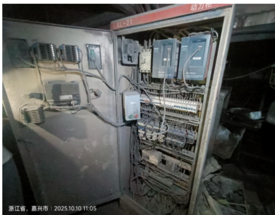
图 13: 动力柜无漏电保护装置、未见接地, 柜门与柜体未见跨接
