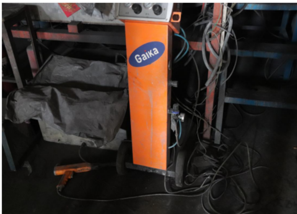
图 9: 喷房西侧靠近事发工位的地面 Gaika 静电粉末涂装机和一把喷枪
