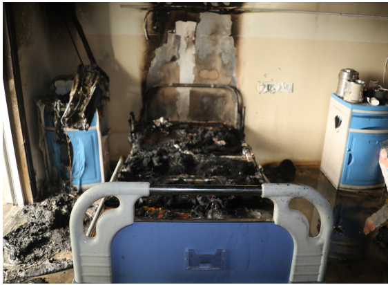
图 4 室内过火情况
