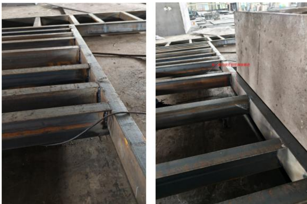
图 5 油箱底座钢架由方钢和槽钢焊接而成，自东向西前七根方钢 T 型接头有明显连续焊缝，第八根之后方钢无焊接痕迹
