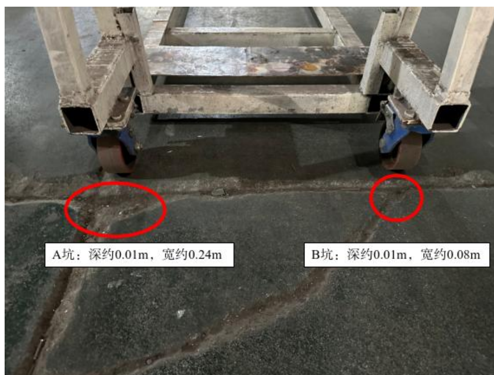
图 2 现场收缩缝破损处示意图
