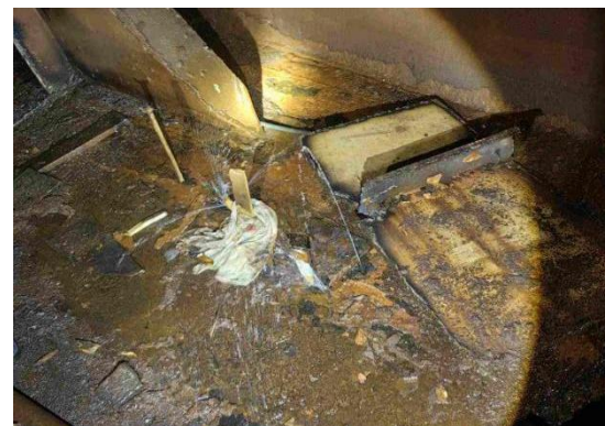
（图六 舱底爆燃后双层底压载水舱顶板焊缝开裂，有油污水喷出）
