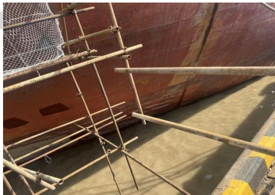
（图三 王某某递送钢管坠落点）
