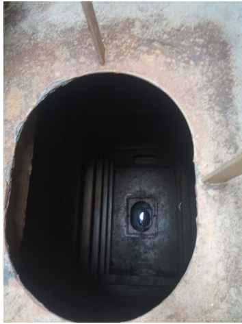
图 2 事故发生部位现场图
