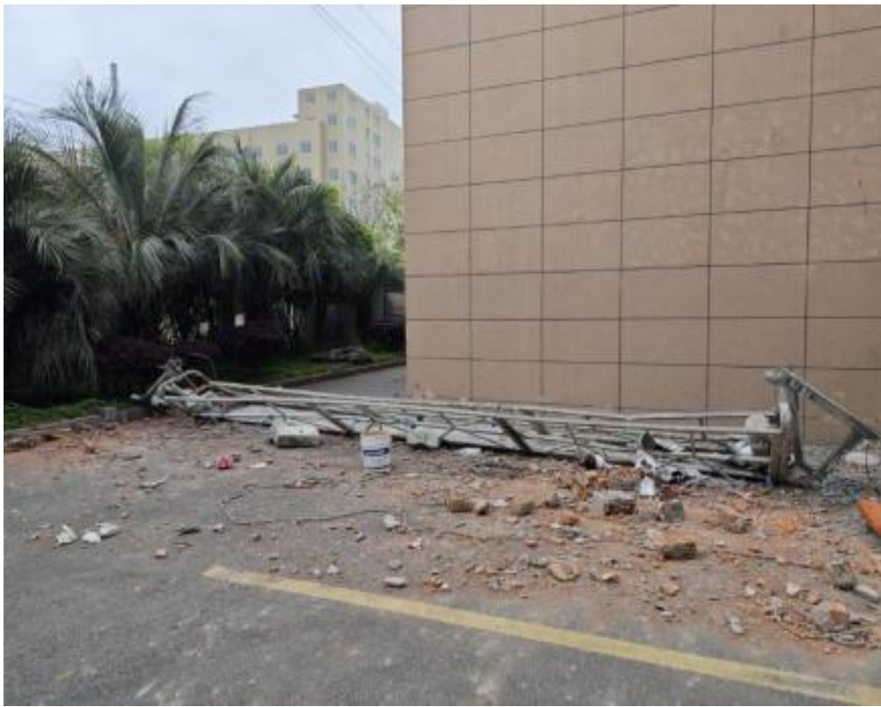
图 5 事故吊篮照片
