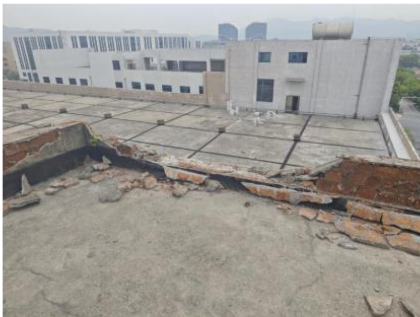
图 2 C 楼南侧楼顶东端搁置点墙体坍塌
