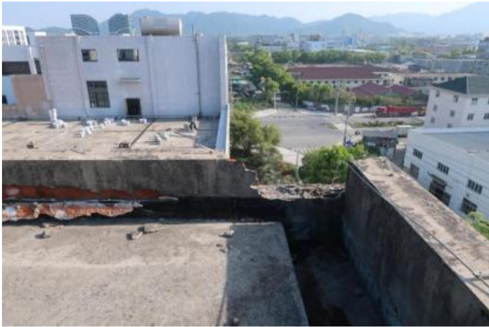
图 3 C 楼南侧楼顶西端搁置点墙体坍塌
