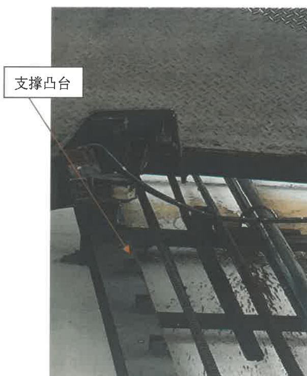
图 4-4 平台东南方向变形的平衡立柱和防坠装置
