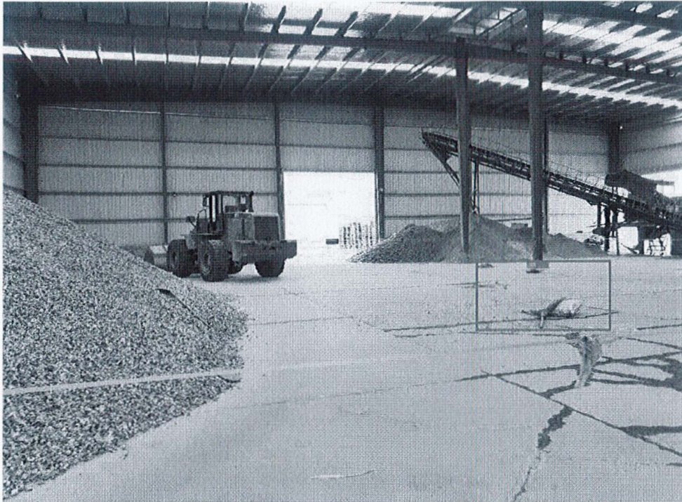
图 3 事 故 发 生 现 场
