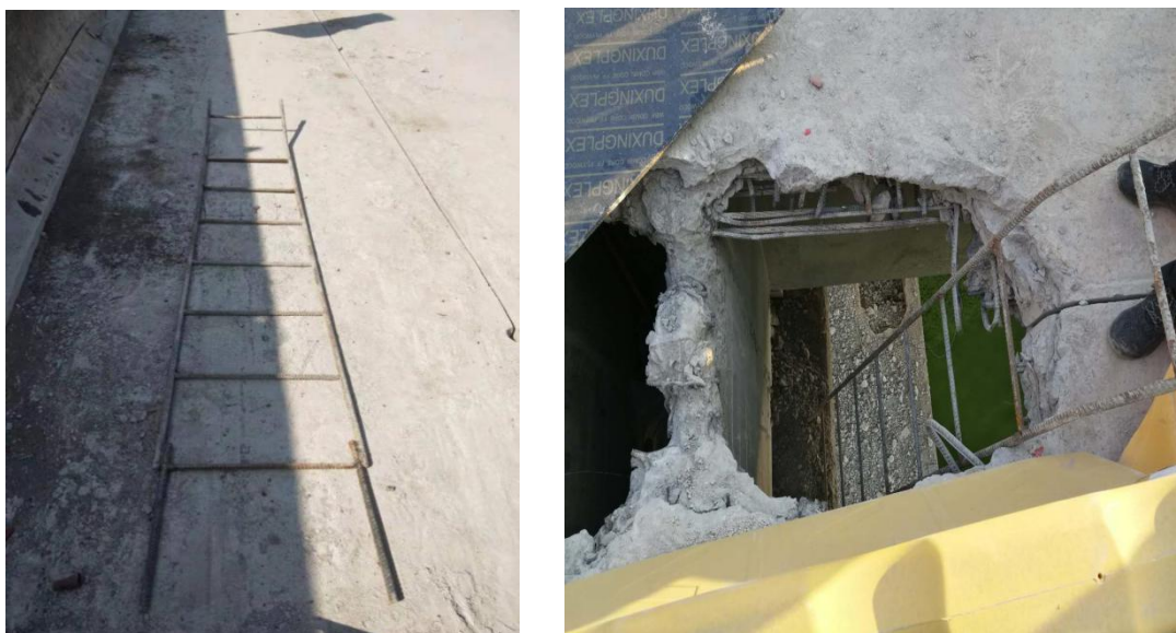
图 2 事故发生时梯子架设方式和坠落距离照片
