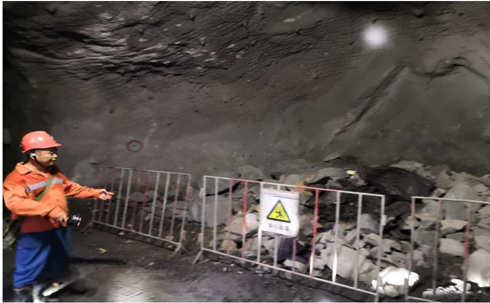
图 1 事故发生地点
