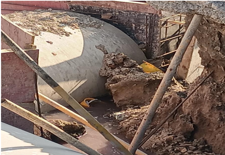
图 3 事故坍塌现场照片
