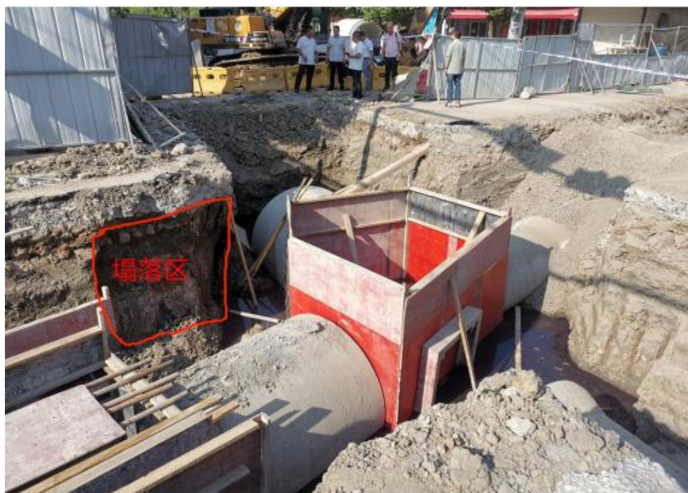
图 2 事故现场照片
