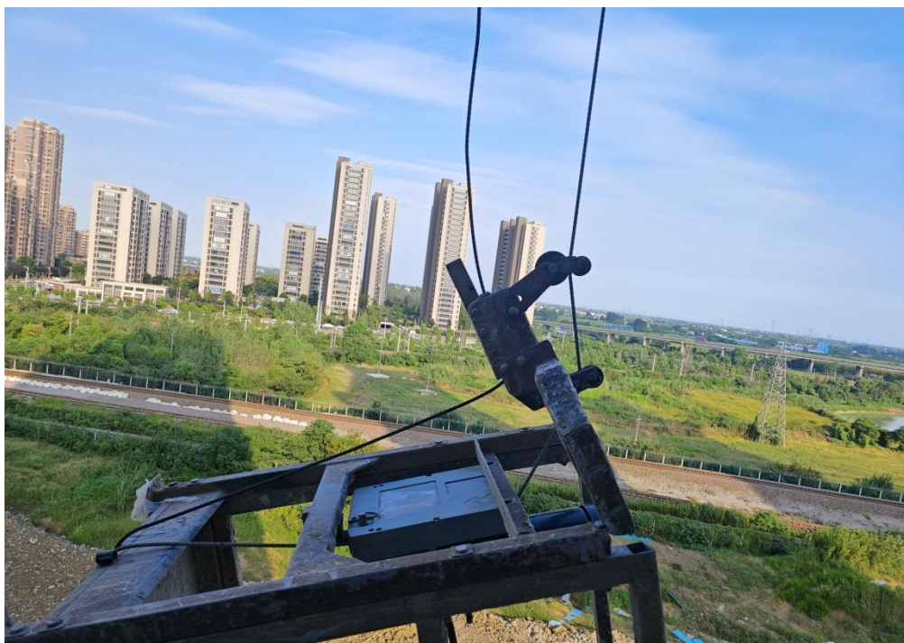
图 4 事故吊篮中安全锁及主钢丝断裂图
