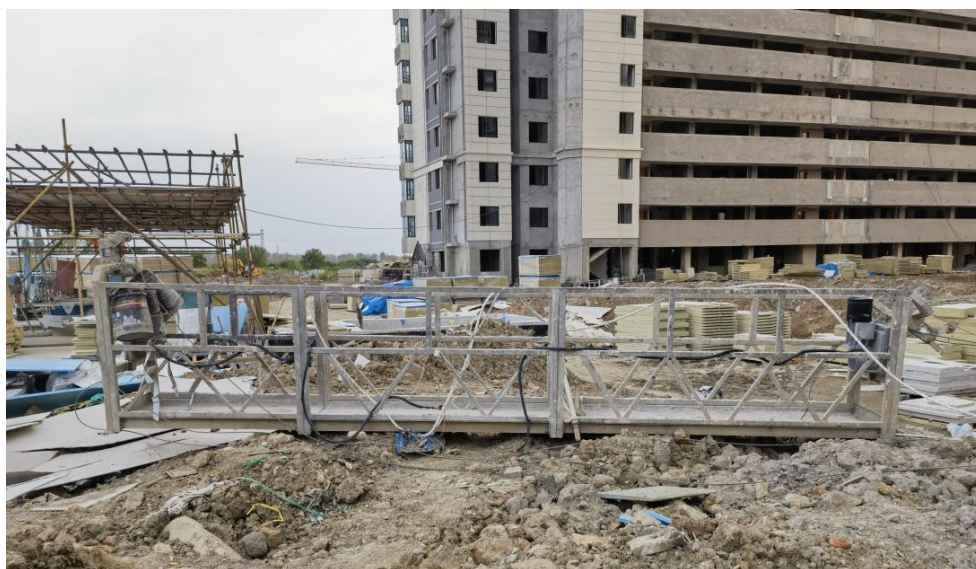
图2 事故发生吊篮整体图
