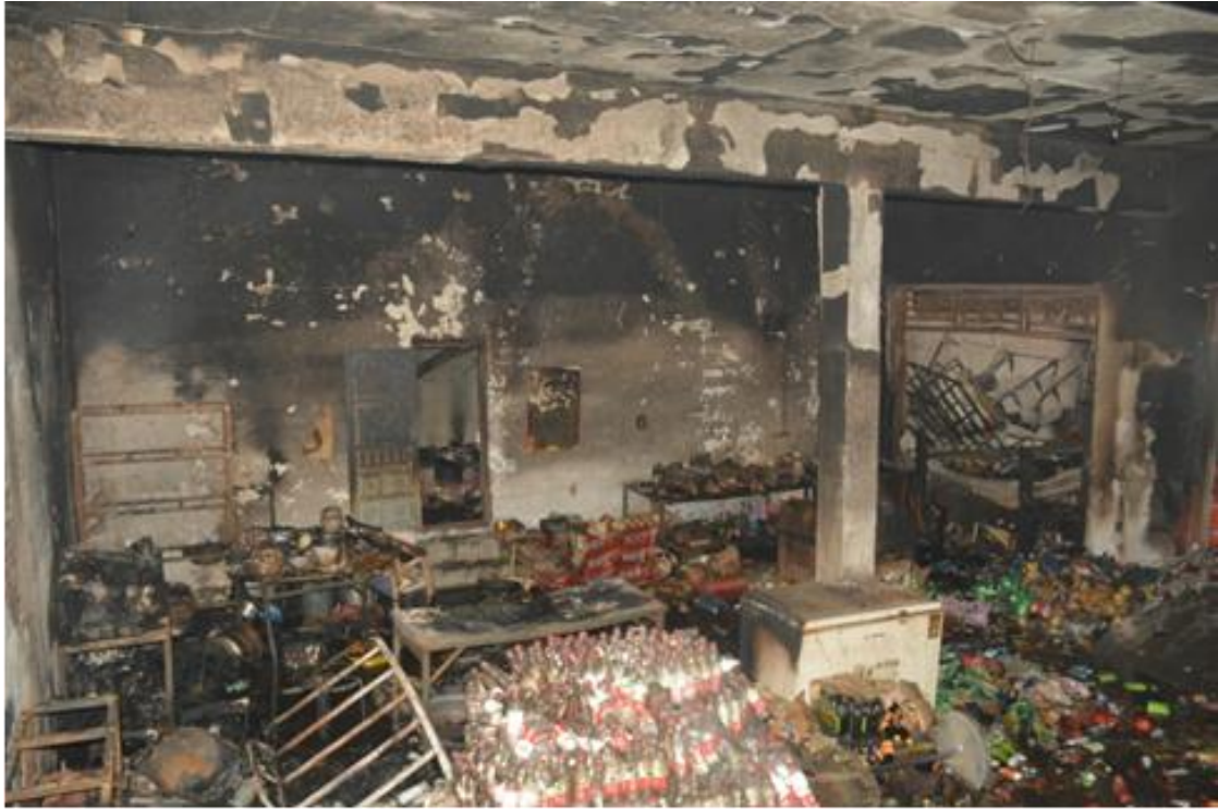
图 7 事故建筑一层后厅过火情况
