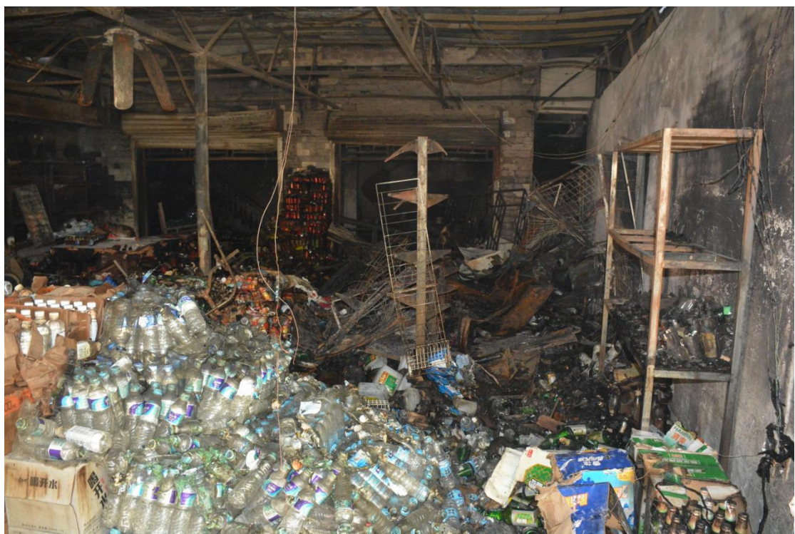
图 5 事故建筑一层前厅东侧过火情况
