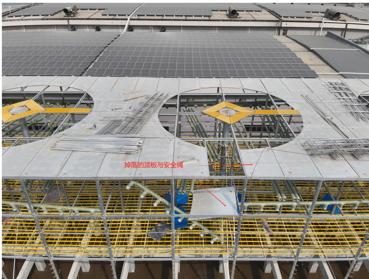
图 3 事发掉落的顶板与安全绳
