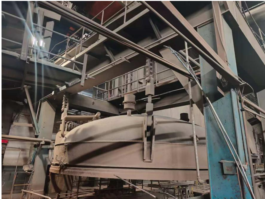
图一 3号精炼炉炉盖
