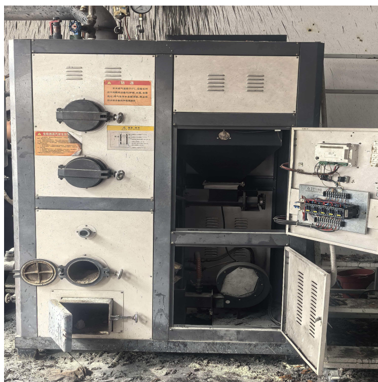
图 2. 锅炉正面（操作面板被烧毁，右下方上门锁的舌板向内呈 45 度弯曲变形）
