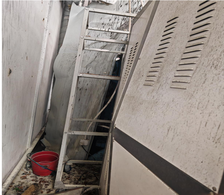
图 3. 锅炉背面（骨架及面板向墙侧突出）
