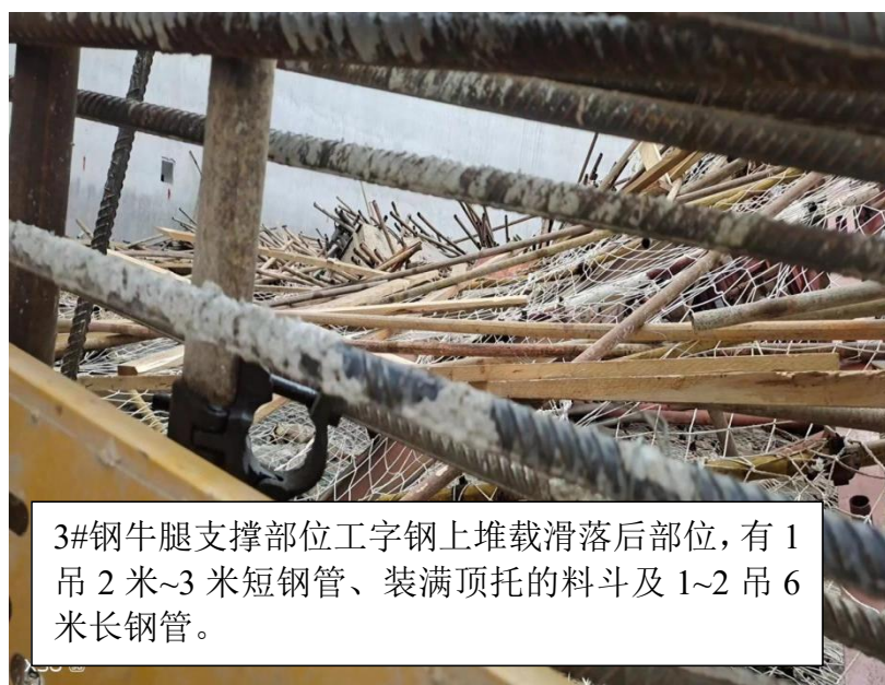
图 10 事发筒仓主要吊物具体在浅圆仓仓顶支架坍塌后图片
