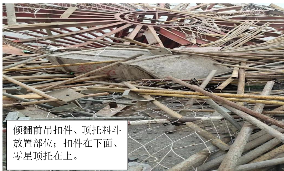
图 12 事发筒仓主要吊物具体在浅圆仓仓顶支架坍塌后图片
