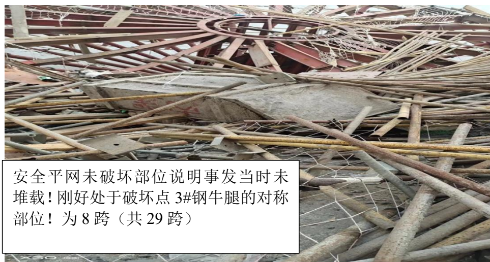
图 13 事发筒仓主要吊物具体在浅圆仓仓顶支架坍塌后图片
