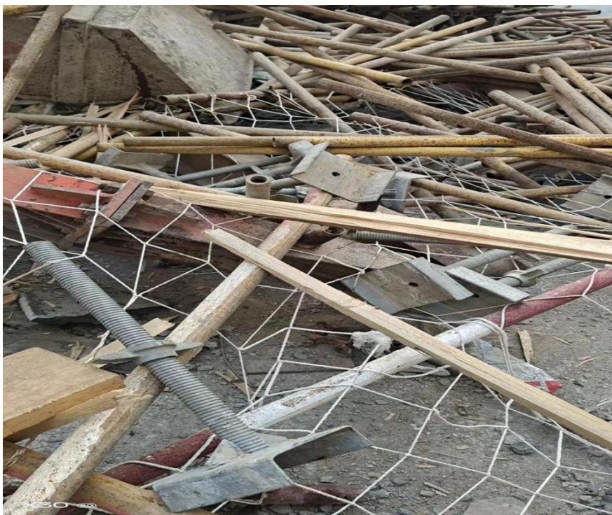
图 11 事发筒仓主要吊物具体在浅圆仓仓顶支架坍塌后图片
