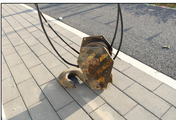
图 5：静力压桩机吊钩固定销缺失 5 根
