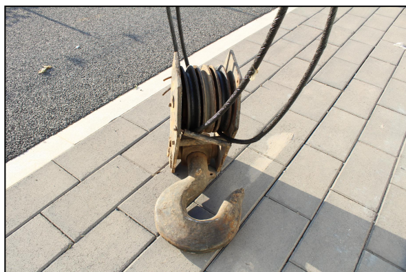
图 4：静力压桩机吊钩防脱销缺失
