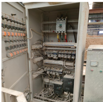
图 3 配电柜未见接地线
