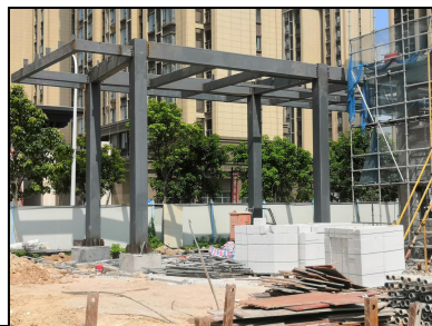
图1：事发临时钢结构南侧
