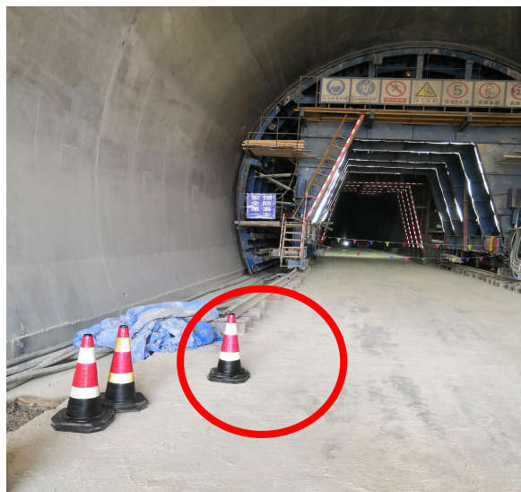
图 4：钟某某和吴某某现场指认事故发生点
