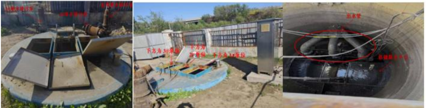
图 2 涉事泵站实景图
