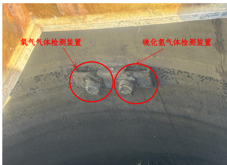
图3 污水井内壁的硫化氢和氧气气体检测装置图
