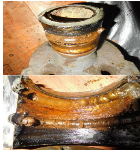
图 12 1 号旋转接头锈蚀情况
