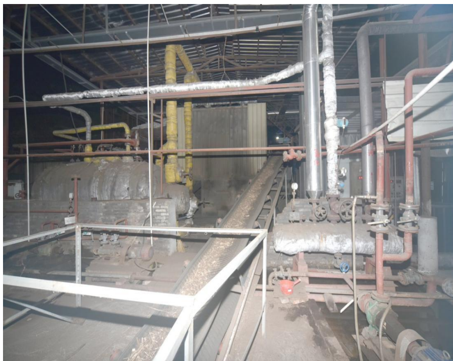
图 1 百新科技锅炉车间带式进料输送机
