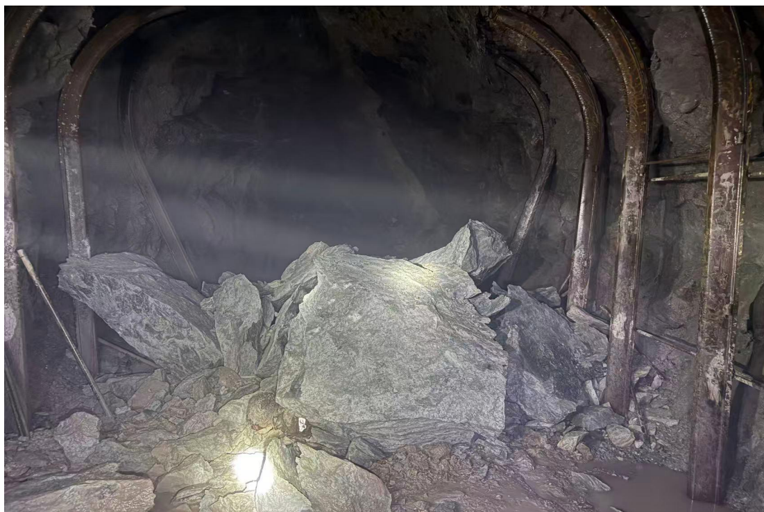
图 4 事故现场情况
