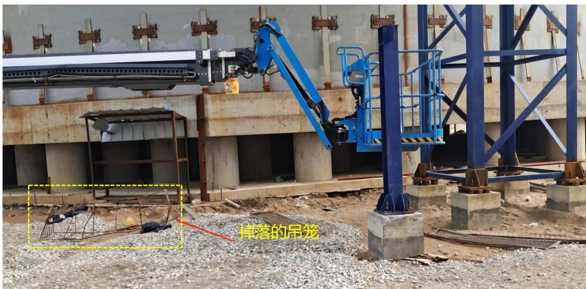
图9 吊笼掉落地点
