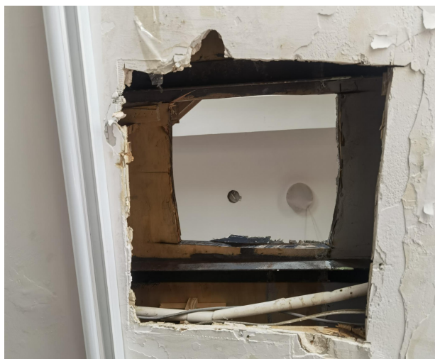
图 7 西侧吊顶隔层洞口
