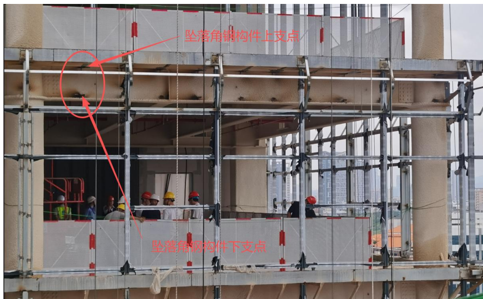
图11 坠落角钢构件割除前所在位置外视图
