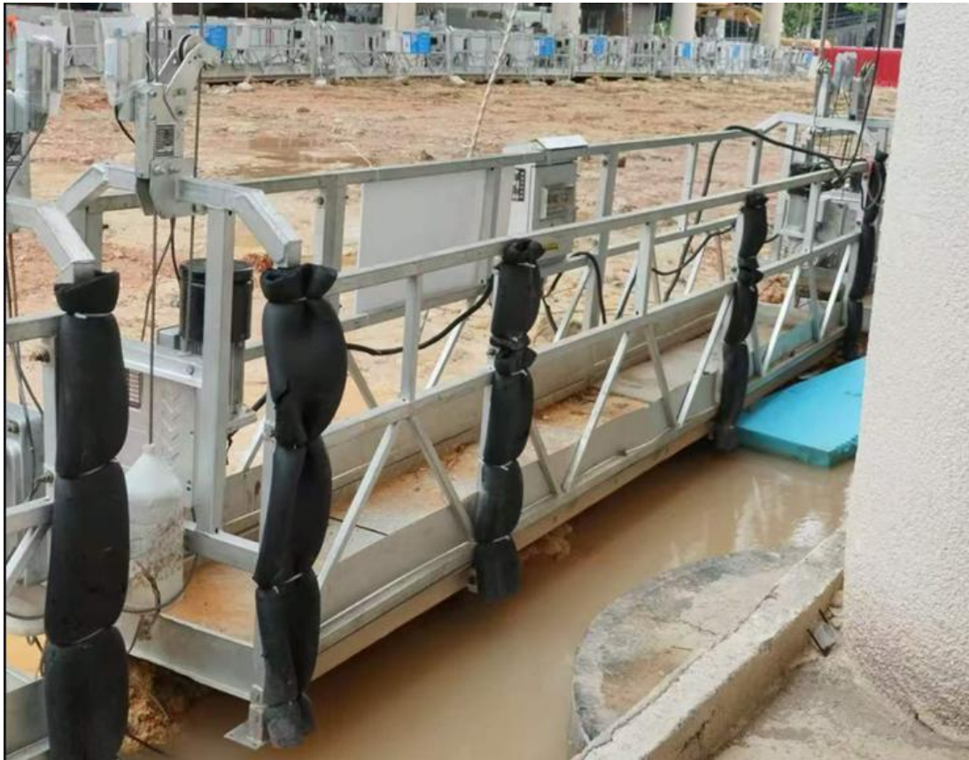
图14 事发时高空作业吊篮
