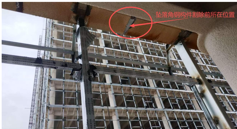
图10 坠落角钢构件割除前所在位置
