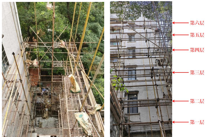
图 8、9 第六层的水平杆刚刚装好，部分安装钢芭，没有栏杆
