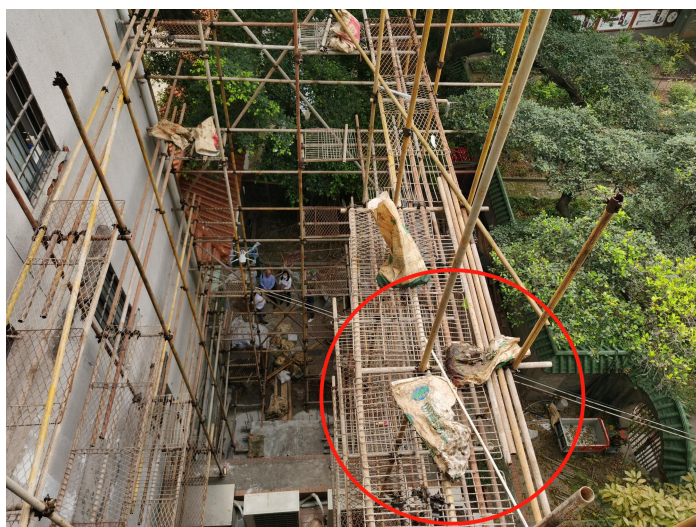
图 10 架体的六层西北角，有立杆刚装上了接驳器，未接驳立杆
