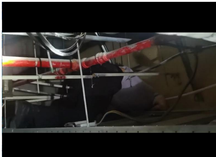
(图 5 事发时吊顶内情况)
