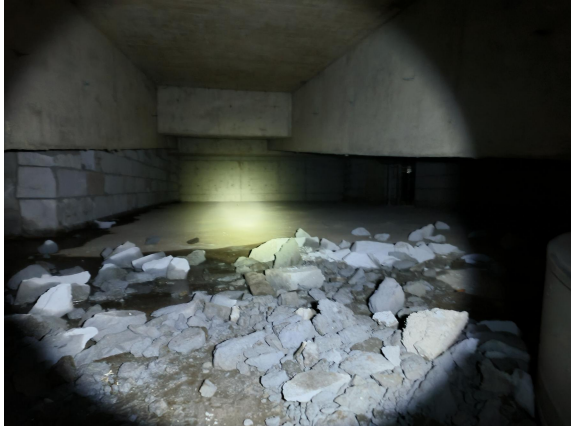
图 9 涉事检修洞内部情况
