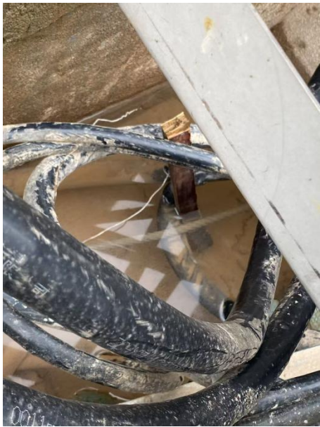
图 11 钢丝绳下方为带电电缆、木条已移位
