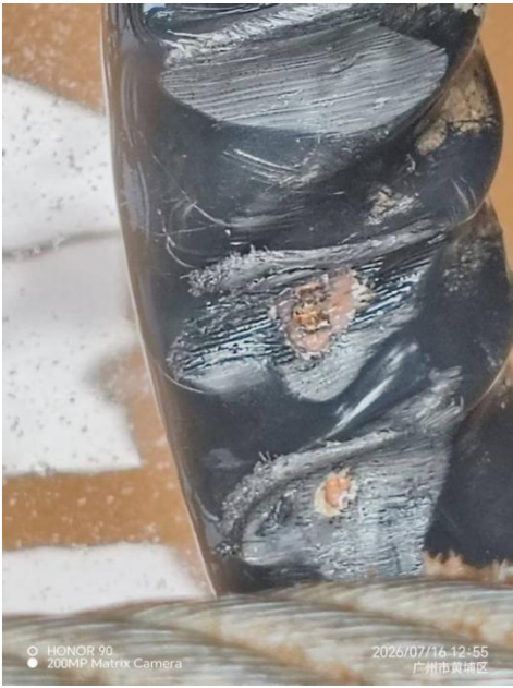
图 12 电缆绝缘层已破损
