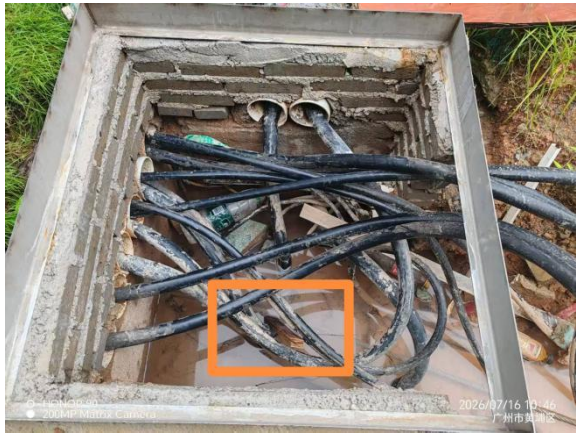
图 10 电缆沟内有积水、隔离用木条已移位
