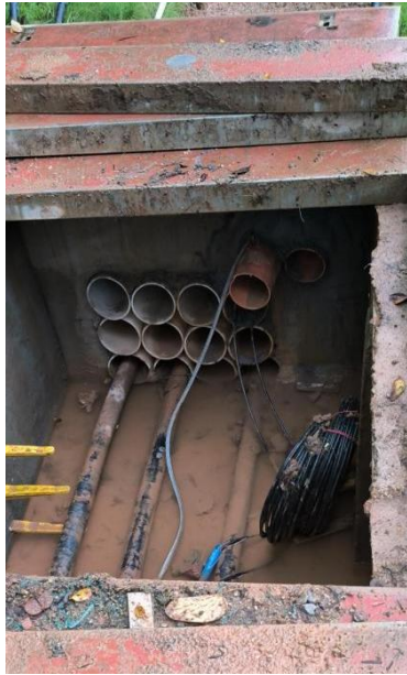
图 7 开关房旁边的电缆井内部
