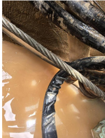
图 8 电缆井内破损的低压电缆
