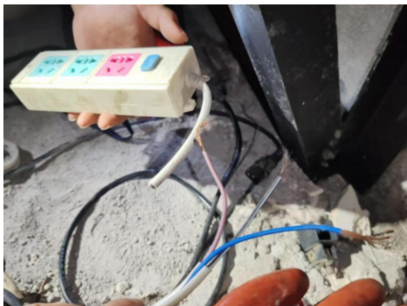
图 5 事故现场被剪断并剥开裸露线头的排插三芯电线
