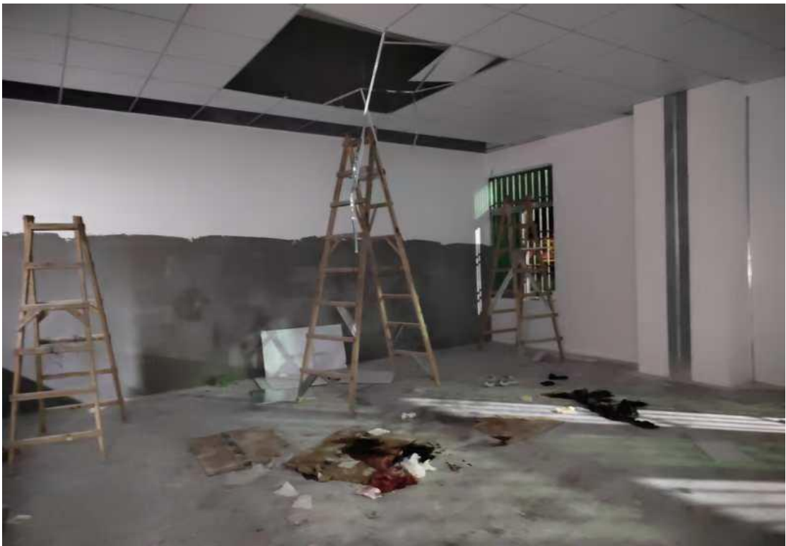
坠落现场情况
