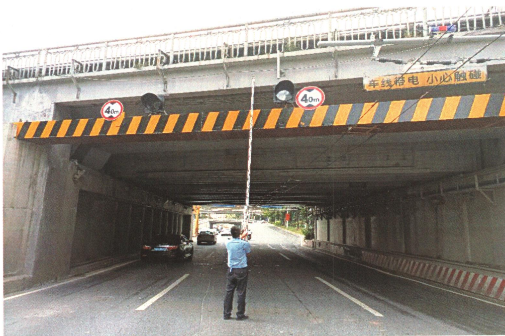
图 8: 事故现场第二个限高架照片(设有限高 4.0m 标志, 实测高度 4.2m)
